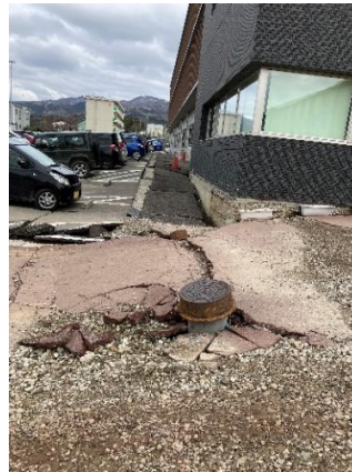
<駐車場は地盤沈下し大きな段差がある>
